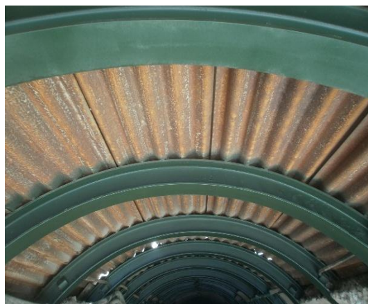
FOTO 1 : PLANCHA COMO CUBIERTA
